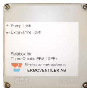
Reläbox för pump och extravärme
